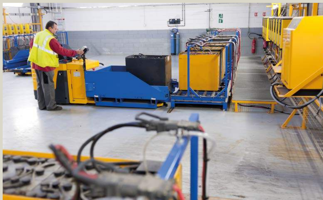
Figure 6. Local de charge de batteries © Grégoire Maisonneuve pour l'INRS
