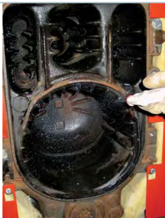
Facultatif : pré-nettoyage chimique du corps de chauffe.
